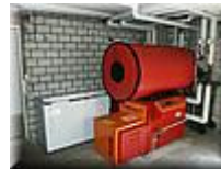
EM 011 Trocknungsraum EG Heizung
