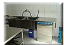
EM 020d Küche 1. OG Abwaschmaschine
