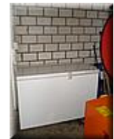
EM 012 Trocknungsraum Tiefkühltruhe EG
